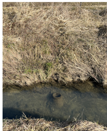
Böschungskopf ins Gewässer abgerutscht
