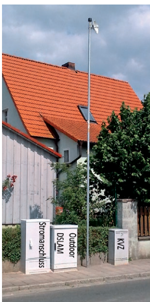
Abb. 67: Outdoor-DSLAM mit Richtfunktankbindung.
