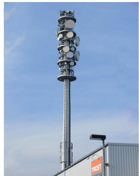
Abb. 68: Parabolantennen auf einem hohen Mast in Karlsruhe.
