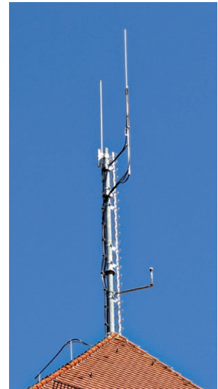
Abb. 64: TETRA-Mobilfunkmast mit Rundstrahlantenne.
