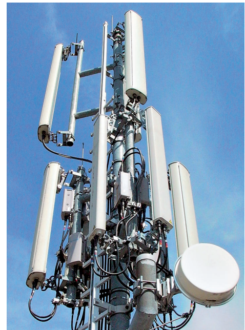
Abb. 56: Mobilfunkmast mit Antennen verschiedener Betreiber. Im Bild unten rechts: eine Richtantenne zur Anbindung an die übergeordnete Netzeinheit.
